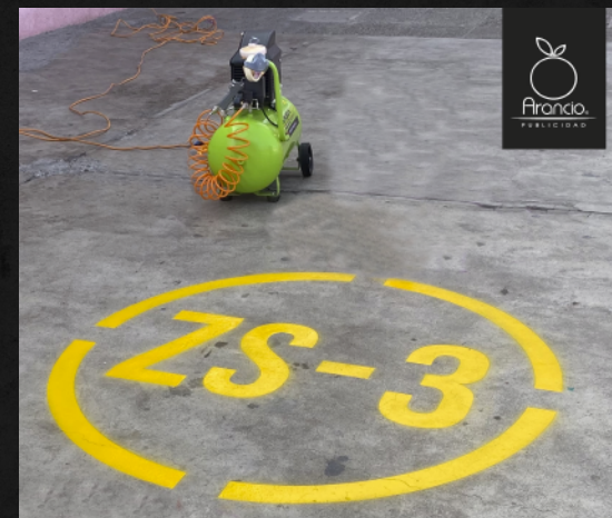
SEÑALÉTICA ZONA SEGURA DEMARCAÇÃO CON PINTURA DE ALTO TRÁFICO
